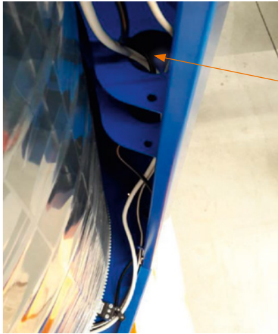
Pasaje de cables
